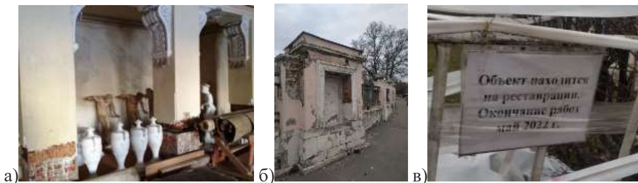
Рис. 2. Останкинский дворец: а) подсобные помещения ; б) ограда дворца; в) объявление об окончании сроков реставрации.
